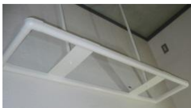
天井アンテナ
