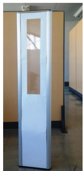
ゲートアンテナ
